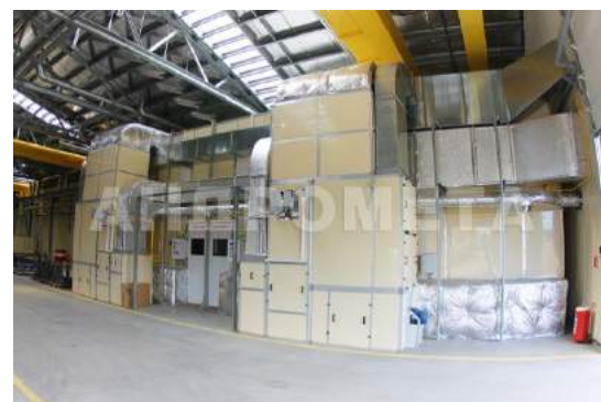
Окрасочно-сушильная камера с контролем температуры.
