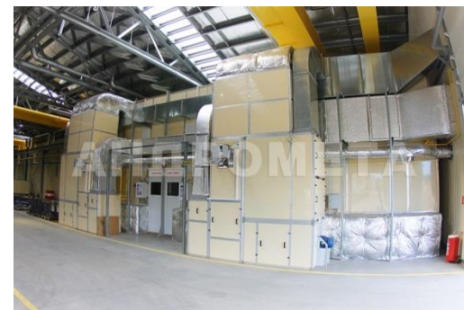
Окрасочно-сушильная камера с контролем температуры.
